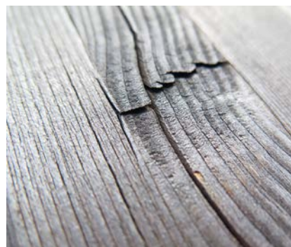
Verletzungsgefahr bei aufstehendem Holzsplitter.
