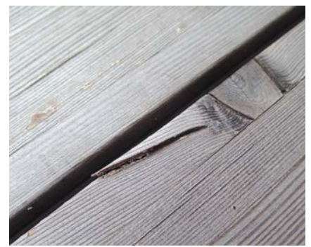
Verletzungsgefahr wegen abgelöstem und aufstehendem Splitter im Kantenbereich.
