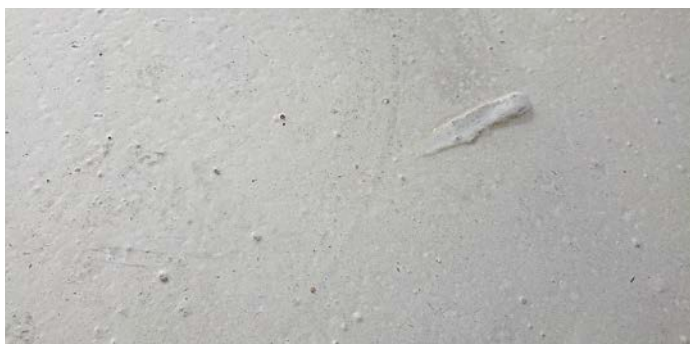
Kleine Buckel und größere Schmutzpartikeleinschlüsse in der Estrichoberfläche.
