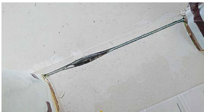
Übermäßig breite Bewegungsfuge in der Mitte des Bodens.
