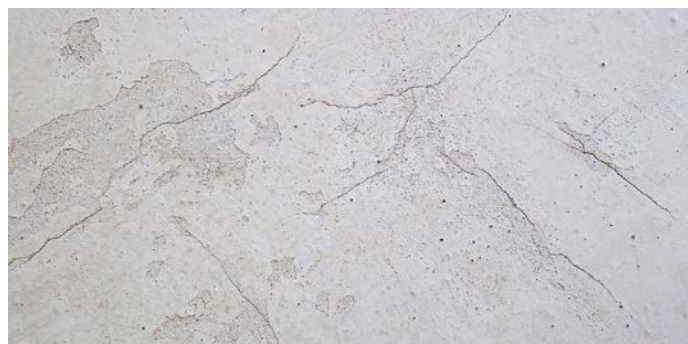
Unnatürliche Risse, geplatzte Blasen sowie Fleckenbildung im Fließ-anhydritmörtel.
