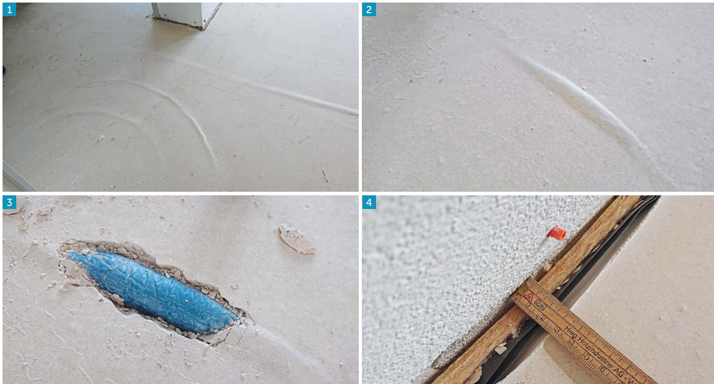
1 Abzeichnungen der Bodenheizungsrohre in der Mörteloberfläche. Bilder: Lysser
