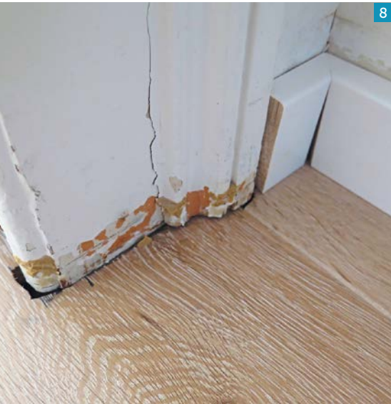
8 Unsauber verarbeitete Sockel in Raumecke.
