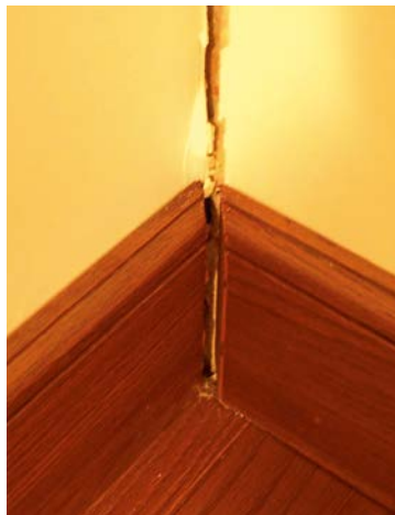
Wandverschiebung infolge von Holzquelldruck.
