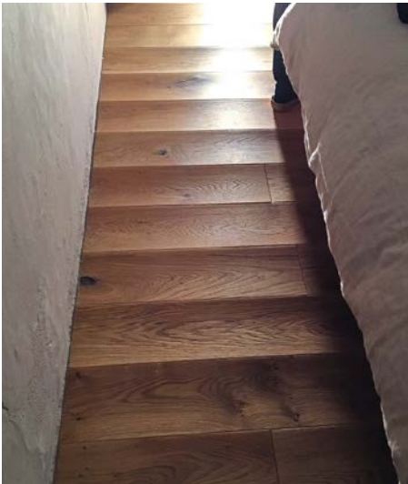
Übermäßige Verformungen resultierend aus zu hoher Holzgleichsfeuchte.
