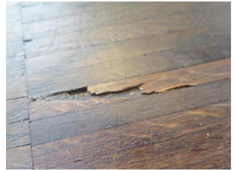
Windrisse mit Absplitterungen und Verletzungsgefahren.
