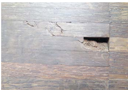
Loch nach Holzausbruch.
