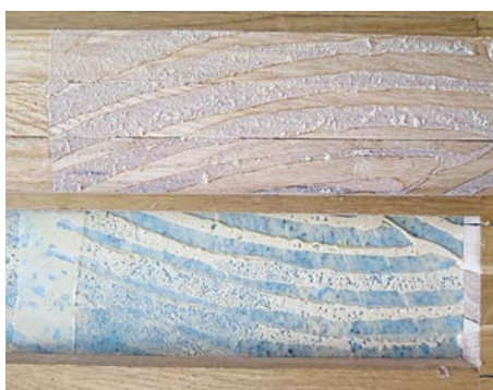
Leimassbruch, entstanden unmittelbar nach der Verlegung.
