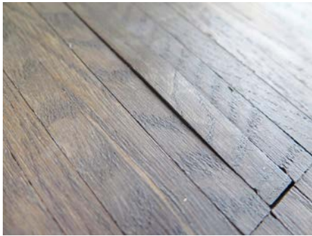
In der Mitte gelöste und verformte Lamelle.
