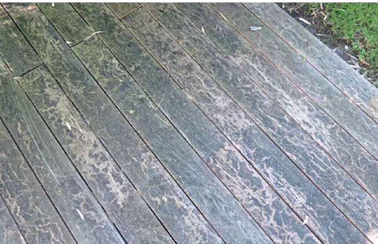
Stark vergraute Holzterrassenoberfläche mit vielen Flecken. Bilder: Lysser
