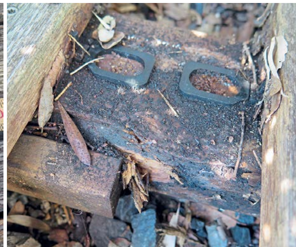
Intensive Verschmutzung in der Unterkonstruktion.
