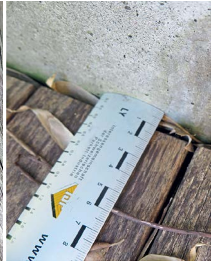
Zu schmale Anschlussfugen gegen den Mauerabschluss hin.
