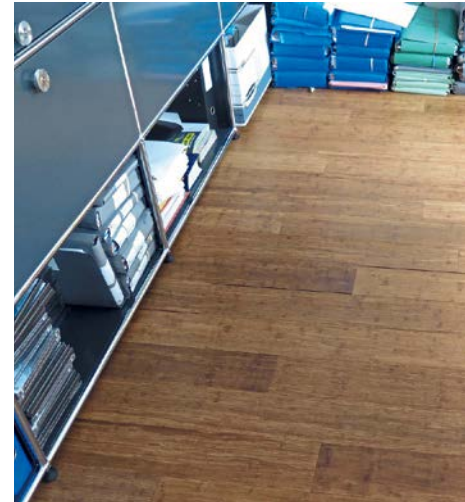
Extrembelastungen durch Akten und Schränke in Randbereichen.
