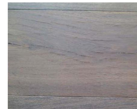
Haarrisse verlaufen nicht tief ins Holz und führen meist auch nicht zu weiteren Rissbildungen.
