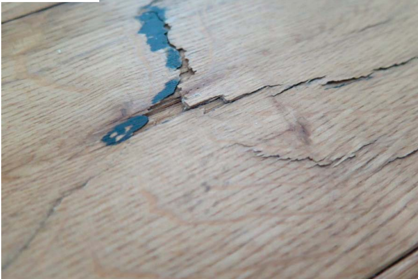
Windrisse haben einen unregelmässigen Verlauf im Holz, oft auch mit Brüchen quer zur Faser: Sie stammen aus übermässigen Biegebeanspruchungen im Stamm durch extreme Windbelastungen, Schneedruck oder unsachgemässen Fällen des Baumes.
